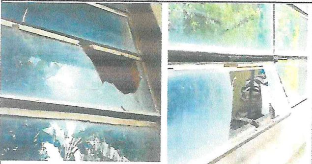
Foto 3: Vidrios en ventanería en mal estado.
