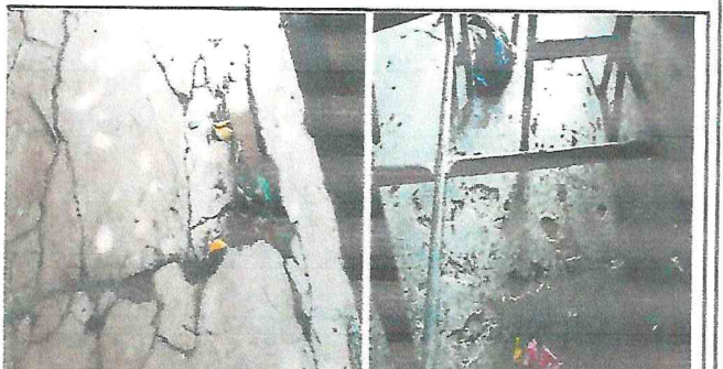
Foto 4: Piso de torta de concreto en mal estado
